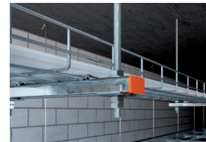
Anschluss der Gewindestange an der Montageschiene.
