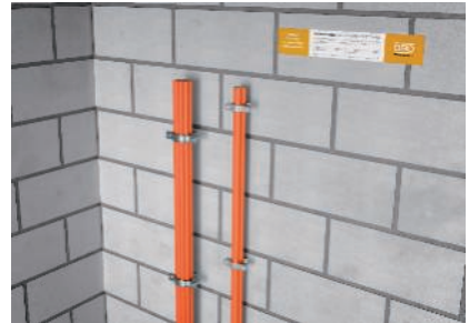
Senkrechte Kabelinstallation als Einzel- und Bündelverlegung an der Wand.
