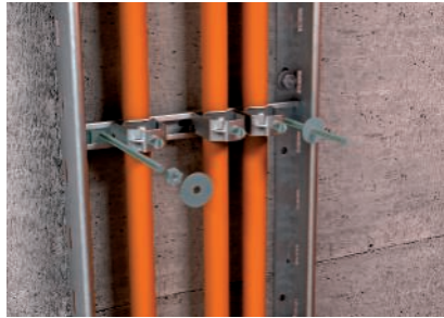
Befestigung in den Sprossen von Steigleitern.
