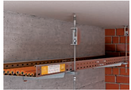
Deckenbefestigung der Gewindestangen mit Brandschutzbügel.
