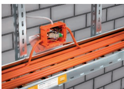
FireBox mit Montageplatte Typ B an der Rückseite einer Kabelleiter montiert.
