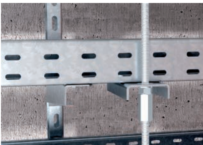
Gewindestangenbefestigung an der Kabelrinne bei mehrlagiger Anordnung.
