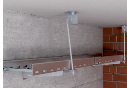
Deckenbefestigung der Gewindestangen mit Brandschutzbügel.
