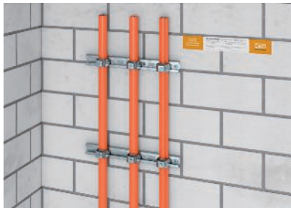
Senkrechte Montage der Kabel an der Wand mit Bügelchellen.
